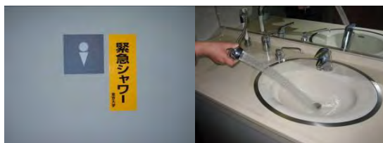
トイレに設置
