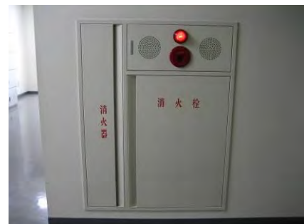
火災報知器（上）と消火栓（下）
