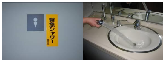
トイレに設置
