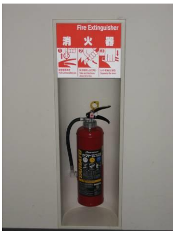
消火器は廊下に設置されている （部屋の中にある場合もある）
