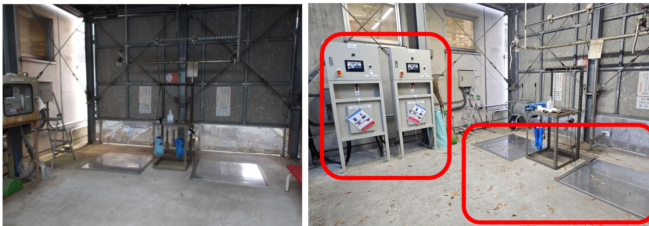
図 2. 自動供給装置更新（左：更新前、右：更新後）
