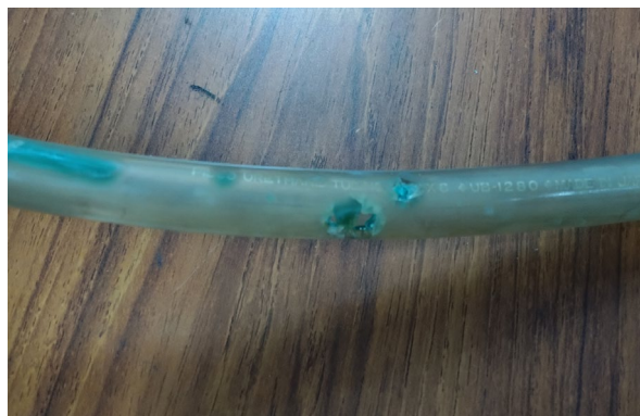
図2 腐食して穴が空いたホースの写真
