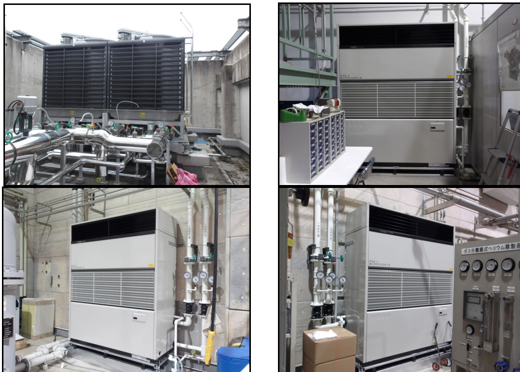
(左上) 冷却塔 (右上) 供給室パッケージエアコン 図 3. (左下) (右下) 圧縮機室パッケージエアコン
