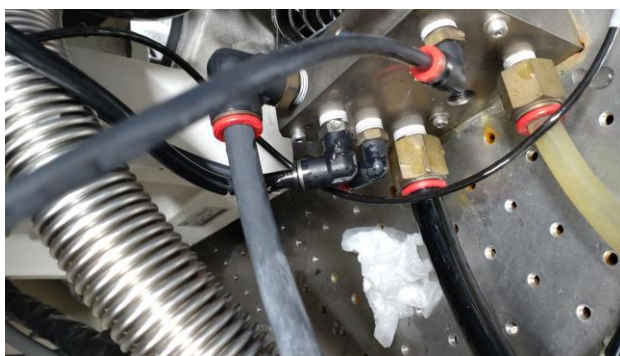
図1 水漏れが生じた場所
