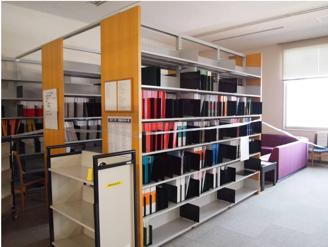
固定書架（未製本雑誌）周辺にロープをはり、立入禁止に（壁面固定金具が外れているため）
