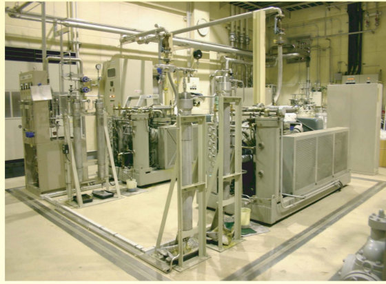
②⑤回収・精製用圧縮機 ブルックハルト社製 190Nm 3 /h×2基
