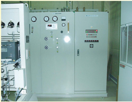
⑥高圧ヘリウムガス乾燥器 小池酸素社製 2筒式 12時間切り替え式
