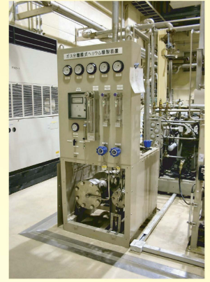
③ヘリウムガス精製器 川崎重工社製 ガス分離膜式 処理能力 144Nm 3 /h
