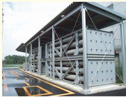
⑦長尺容器 貯蔵能力 4,500Nm 3 A (2,250Nm 3 ), B (1,350Nm 3 ), C (900Nm 3 ) 3系統 切り替え使用可能
