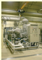
⑨ヘリウム液化機用圧縮機 前川製作所製 2520MSC 処理能力 1,660Nm 3 /h
