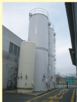
①④回収ガスホルダー 70m 3 ×2基
