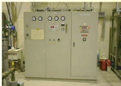
⑧中圧ヘリウムガス乾燥器 小池酸素社製 2筒式 24時間切り替え式
