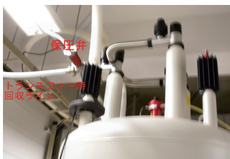
NMRの回収ライン
