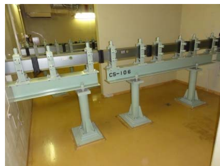
写真 1 : C1 ライン (旧導管)
