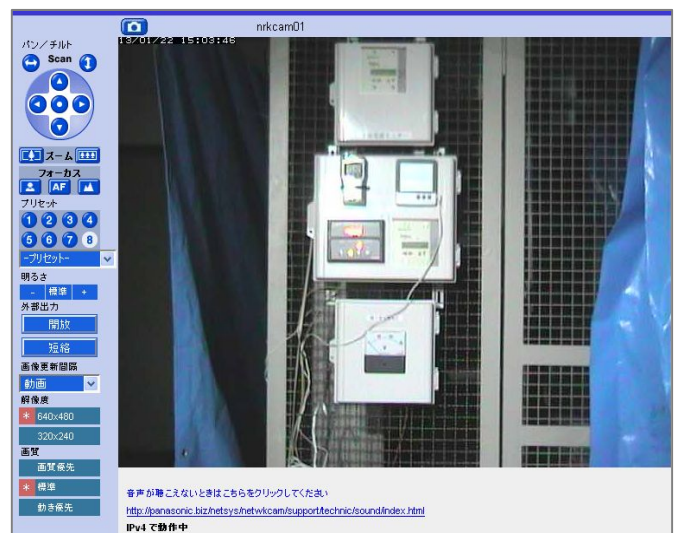
図-2 太陽光発電設備モニター類
