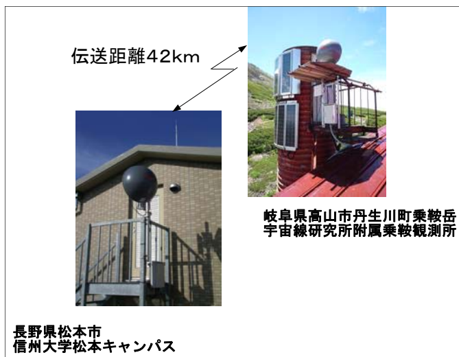
図-6 長距離無線 LAN 設備 (乗鞍観測所—長野県松本市 信州大学間)
