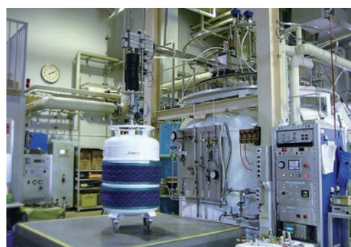
ヘリウム液化機、貯槽及び遠心汲上げポンプ Helium liquefier, storage, and transfer system
