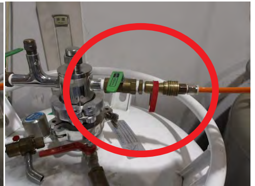
接続されているがバルブが開！
